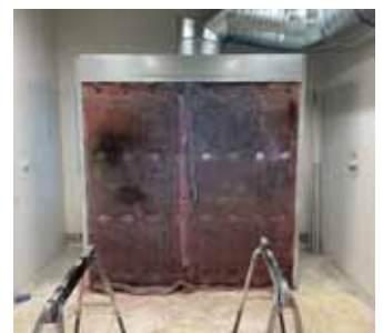
Den nya miljösäkrade lackverkstaden blev klar att tas i bruk vid årsskiftet 2022/23.
